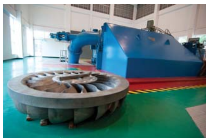
Turbine สำหรับผลิตไฟฟ้า : ภาพจาก การไฟฟ้าส่วนภูมิภาค
